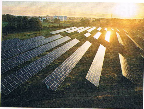
W Przejazdowie koło Gdańska znajduje się jedna z większych elektrowni słonecznych w Polsce. Może ona wytworzyć prąd dla ok. 700 domostw.
